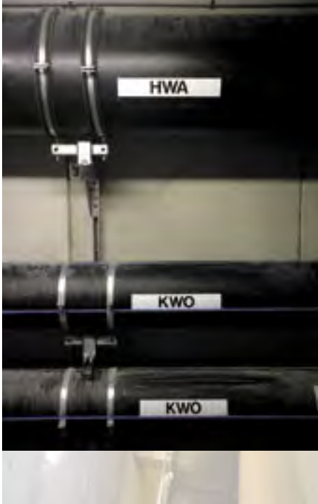
'Naast de 'normale' nutsvoorzieningen zijn in de tunnel de leidingen voor het ondergrondse afvaltransport en de leidingen voor de koude- en warmteopslag opgenomen.' De leidingen voor Hemel Water Afvoer (HWA) en Koude/Warmte-Opslag (KWO) in de kabels- en leidingentunnel van Arnhem CS.
